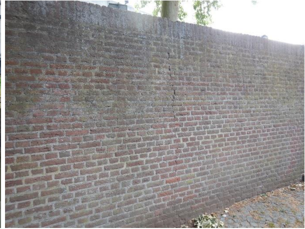
Figuur 10-8: Verticale scheur door verhinderde vervorming
