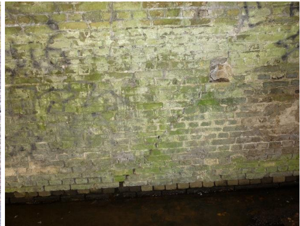
Figuur 10-10: Trapvormige scheur door zettingsverschil (falen fundering)
