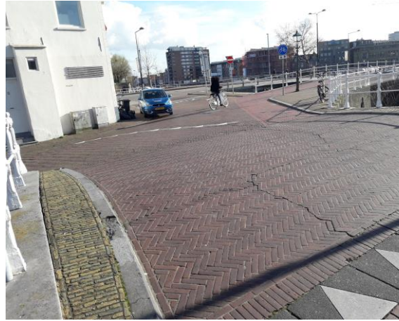
Figuur 10-20: Scheuren in straatwerk, direct gelegd in specie op de boog
