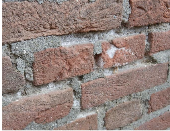
Figuur 10-2: Cementgebonden voegmortel losgekomen.
